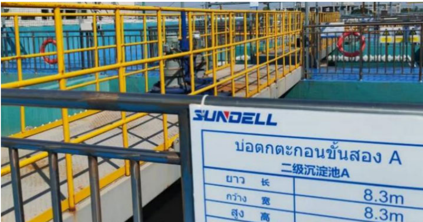
污水处理水池及设备
